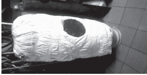
FIGURA 8. MONTAJE AISLANTE (LANA DE VIDRIO)
